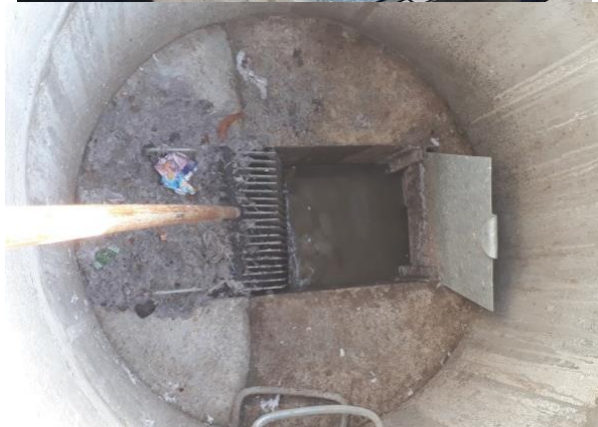
Cámara de Rejas, Pozo de Elevación y Homogenización
